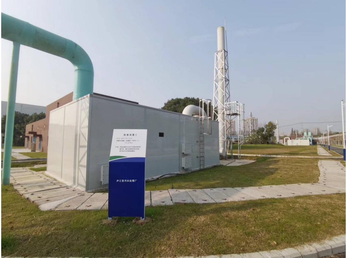
图 3-2 4#生物除臭装置（风量 15000m 3 /h）
