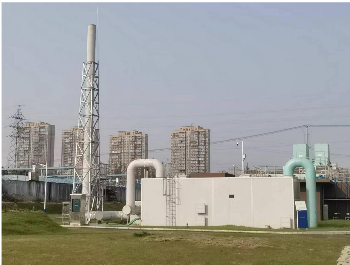
图 3-1 3#生物除臭装置（风量 10000m 3 /h）
