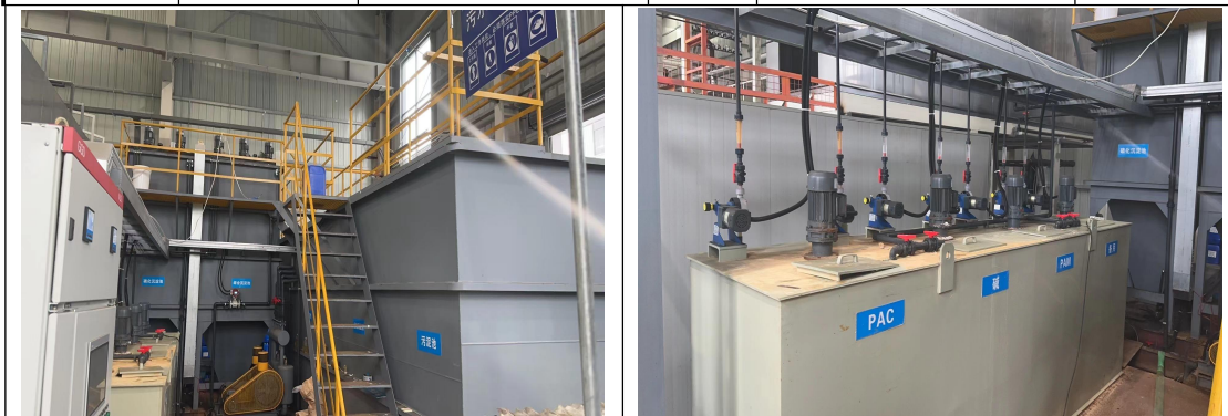
图 3-3 废水处理设施
