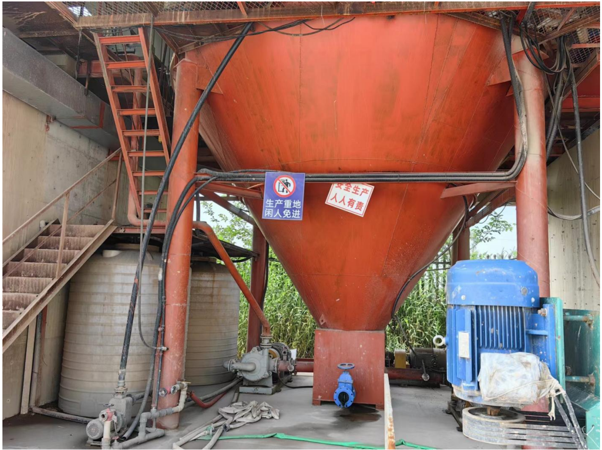
附图 5-6 废水处理设施
