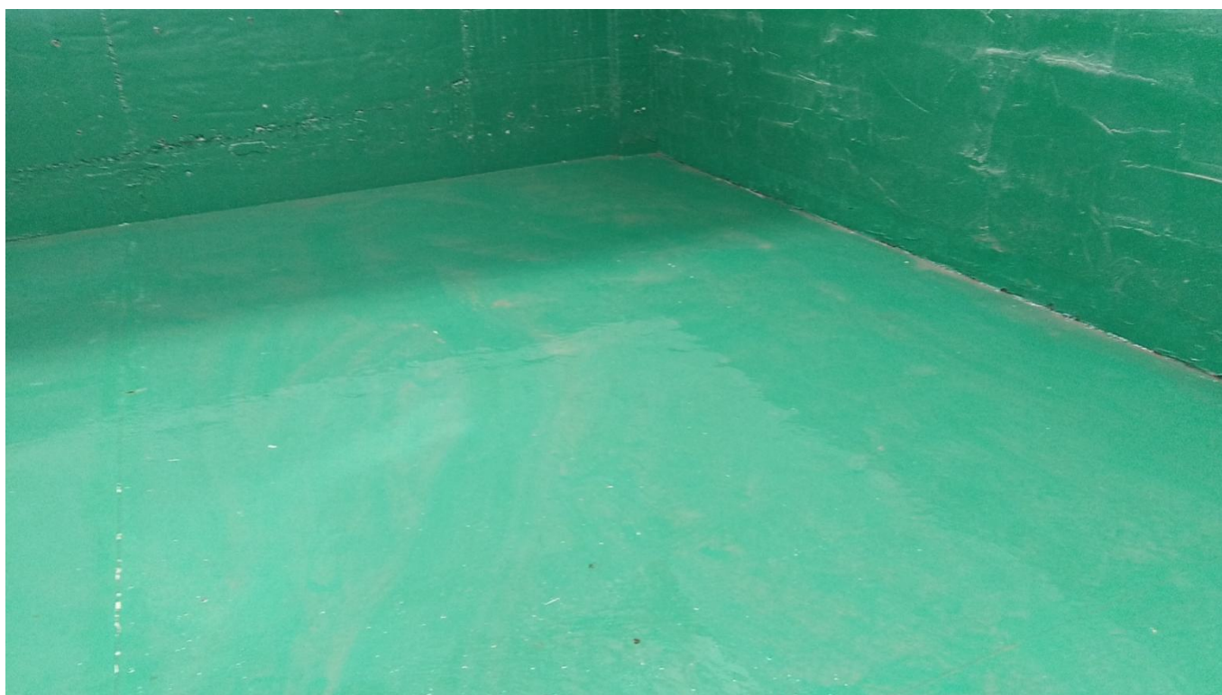
附图 5-3 危废间防渗措施
