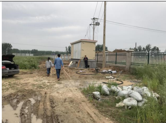
厂内临时用电设施
