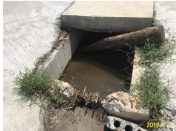
2#监测点位（厂区北侧雨水排口前沉砂池）
