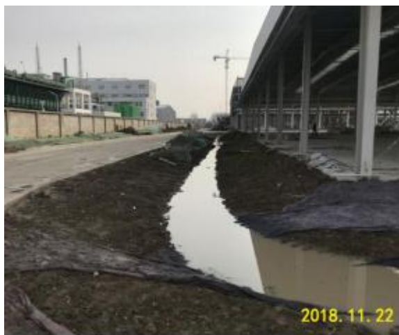
V 型排水沟
